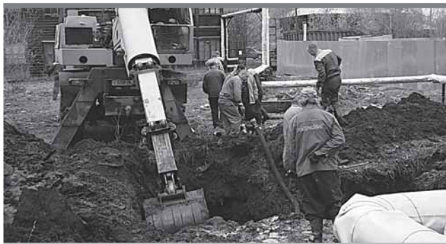
На месте аварии — бригада МЧС и провинившиеся строители
