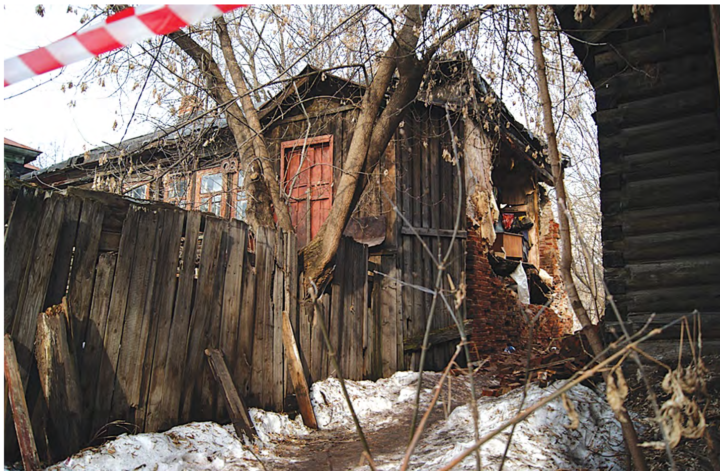
Вместо рухнувшей стены дома № 4 по ул. Достоевского — зияющий провал, вряд ли способный выполнить функцию панорамного окна
